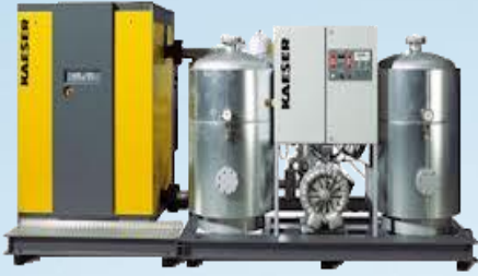
Installation et entretien des compresseurs, sécheurs et filtres
